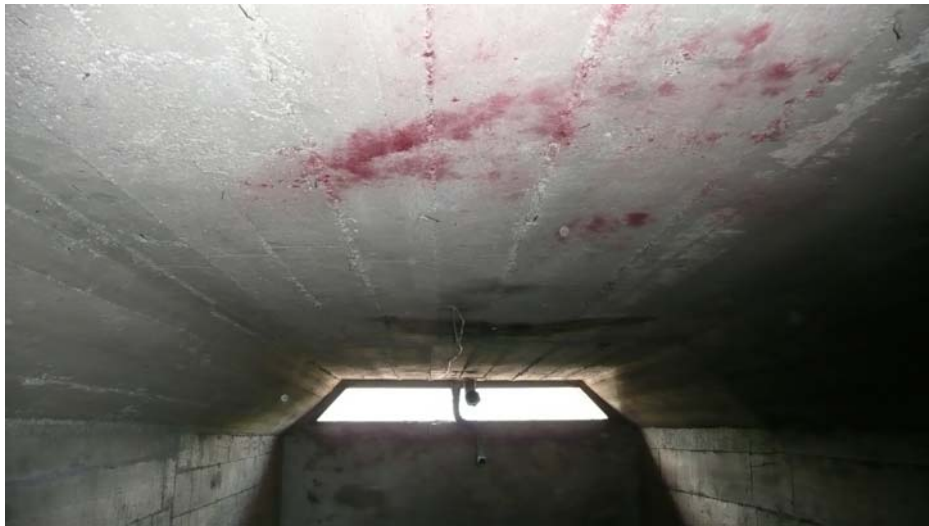
Foto 5- Visuale interna di un vano tecnico
